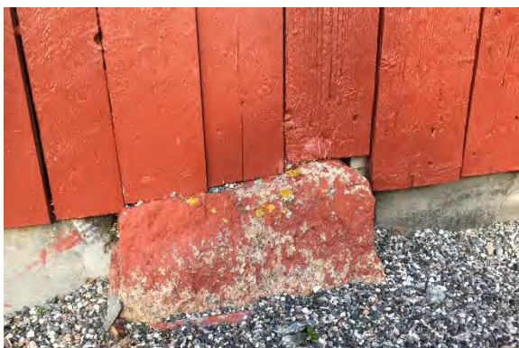
Botnsvilla er borte. Deler av låven hviler på betong. Granittpilaren er blitt staffasje.
